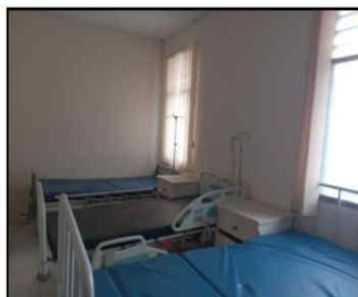
Ruang Halimun yang belum memiliki outlet Oksigen
